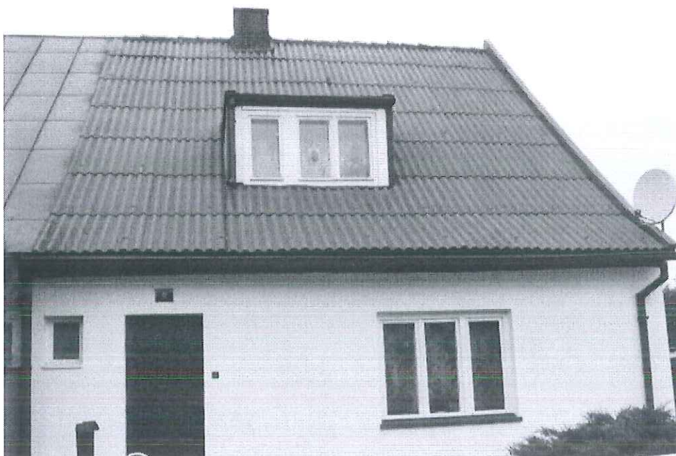
Rysunek 6 Pokrycie dachowe ocenione w III stopniu pilności.
